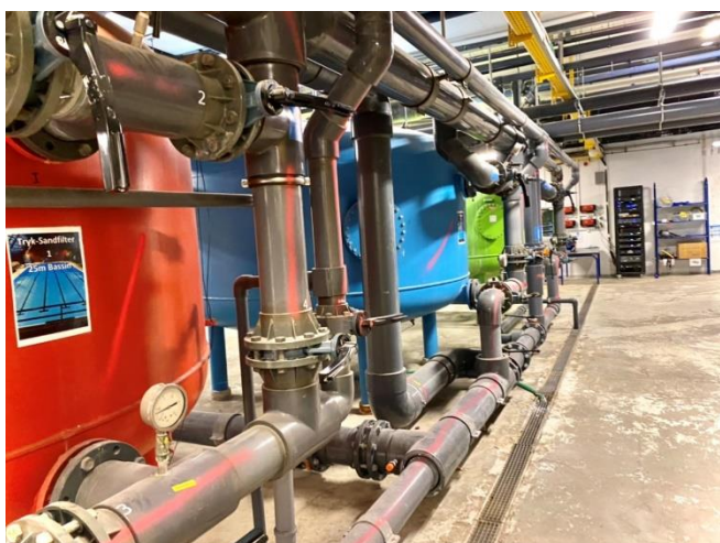
Billede ovenfor: nuværende vandbehandlingsanlæg i kælderen.
